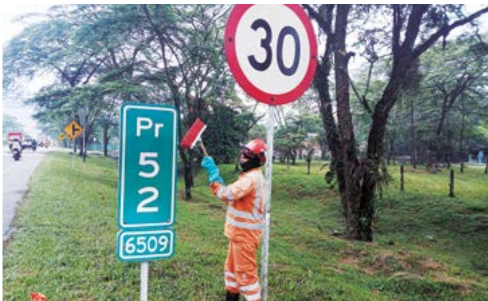
El mantenimiento de la señalización vertical es importante para contribuir a una conducción más segura.
