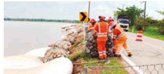
Tanto la instalación de los geocontenedores como los gaviones han contribuido a que, desde el momento que inició la emergencia en julio del año pasado, la vía continúe operando con normalidad.
