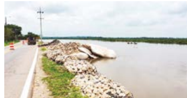
Los cuatro espolones en roca ayudan a mitigar el impacto directo del cauce sobre la estructura de la vía.
