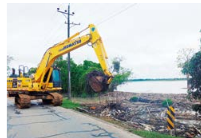
En el sector del puente Carlos Lleras, en inmediaciones del río Metica, para proteger la vía fue necesario realizar mantenimiento riguroso de los canales y alcantarillas para mitigar la afectación del río.
