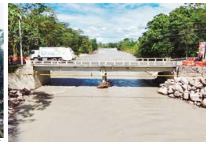
En el caño Camelias, entre Guamal y San Martín, fue necesario tomar medidas de emergencia para proteger el puente de los embates del río.
