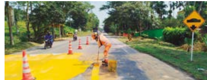
El repintado de las marcas viales como los reductores de velocidad y/o las zonas escolares ayuda a mejorar la seguridad para los usuarios.
