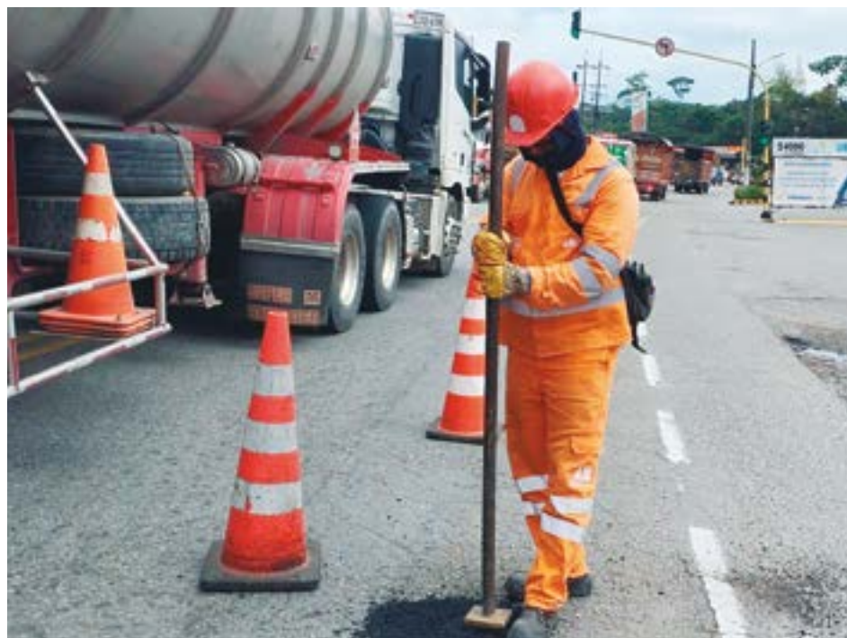
El parcheo menor es importante para que las vías estén en buenas condiciones para una movilidad segura.
