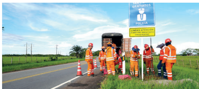
La Concesión realizó la instalación y reposición de 358 tableros de señalización y 520 señales verticales para ofrecer mayor seguridad a los usuarios.
