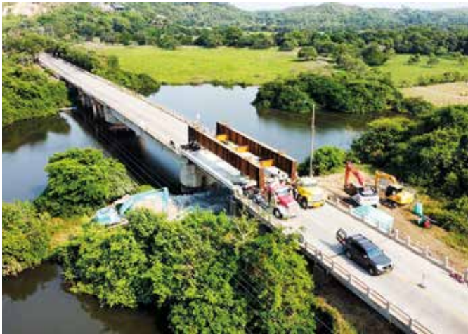
El reemplazo de las dos secciones se realizó en dos jornadas que duraron 30 horas cada una, con el objetivo de alargar la vida útil del puente.
