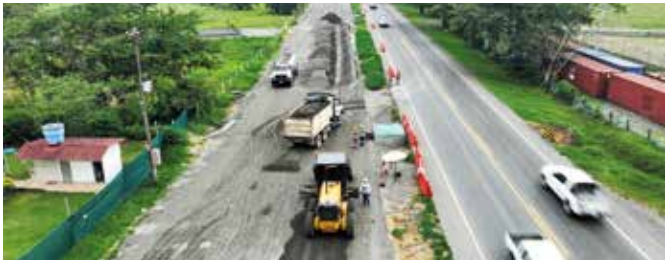
Construcción de la segunda calzada a Acacías en el sector de Las Mercedes.
