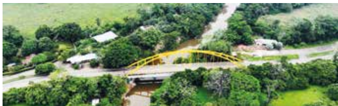
Actividades de mantenimiento del puente La Balsa en la vía Villavicencio - Puerto López.
