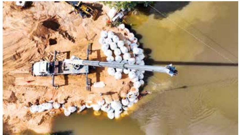
En el costado de Puerto Gaitán se terminaron 4 de los 8 pilotes y se avanza en la construcción del estribo.
