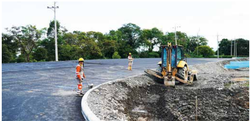
En La Unión se pavimentó el retorno de 656 metros de vía y actualmente se trabaja en la construcción de cunetas y la instalación de bordillos.
