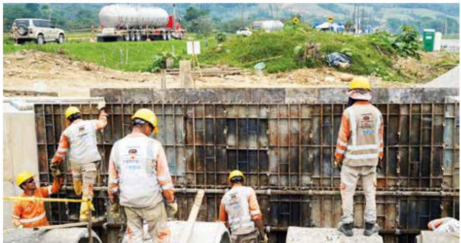
En el frente de obra entre el kilómetro 18 y el 20 también se construirá el área de servicio y la ampliación de la estación de peaje de Ocoa.
