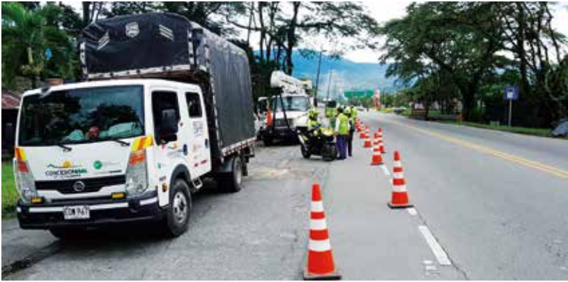
Sobre la vía nacional en jurisdicción del municipio de Acacías se instaló un paso provisional de fauna.
