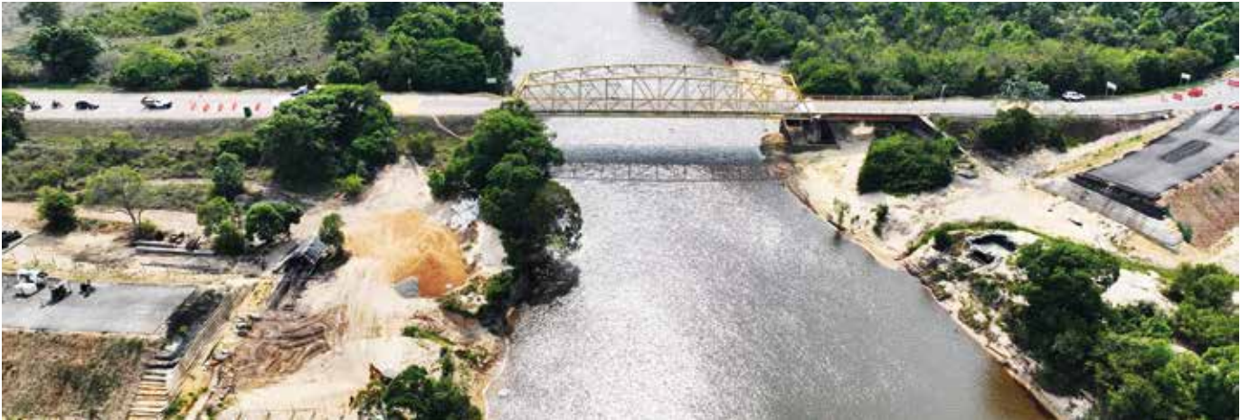
En el sector de Yucao (en el K 101 de la vía Puerto López – Puerto Gaitán) se adelantan las obras de cimentación del nuevo puente.
