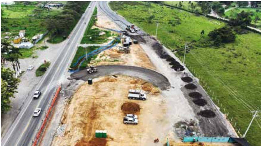
En la vereda Las Mercedes, sector La Unión, está el primer frente de obra de la segunda calzada de la vía Villavicencio – Acacías.
