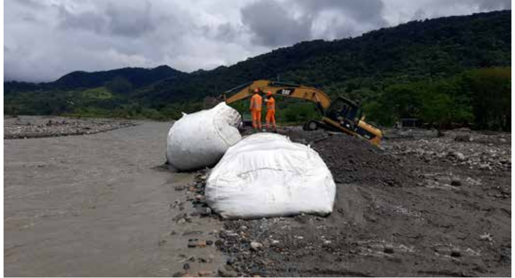
Instalación de geocontenedores en el sector del Guayuriba para mitigar el impacto del río y proteger la vía nacional.
