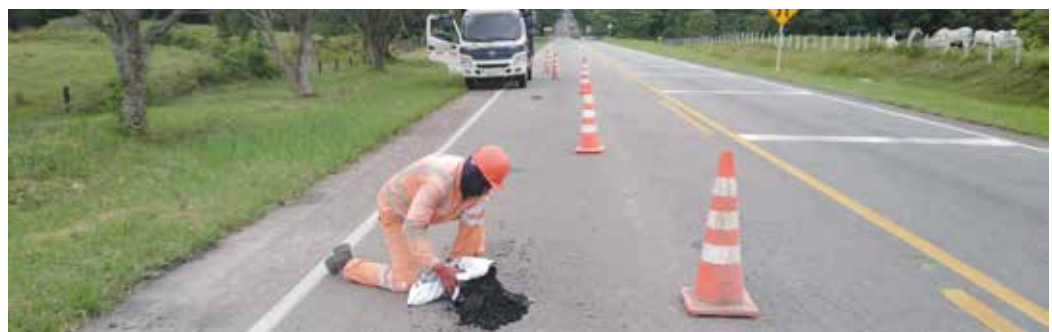
Reparcho de la vía entre Guamal y San Martín, en el sector de Marayal.
