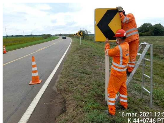
PR44+0746 Puerto López – Puerto Gaitán, reposición de delineador de curva por baja reflectividad.
