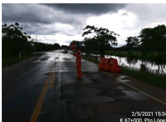
K66+500 al K68+500 Villavicencio – Puerto López, señalización de las áreas afectadas.
