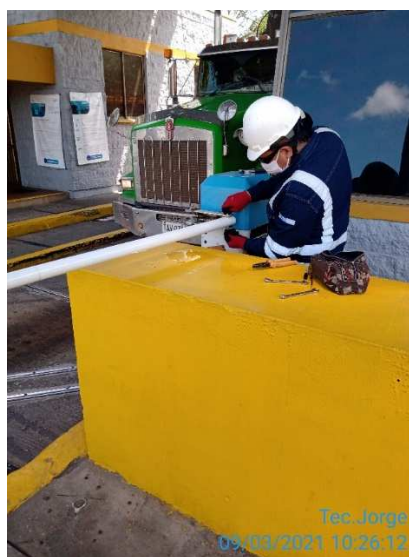
Mantenimiento de equipos Peaje La Libertad
