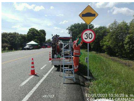
K68+402 Villavicencio - Granada, reposición de tableros por baja reflectividad.
