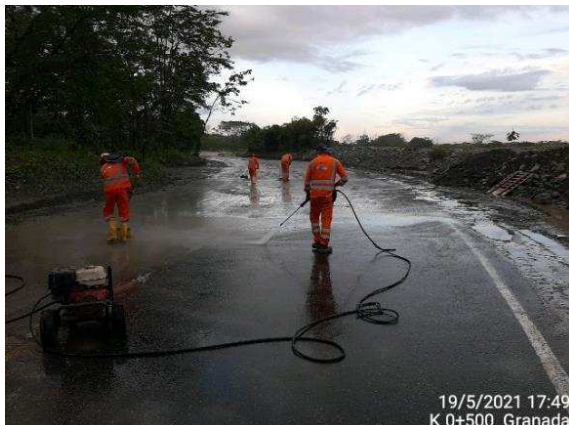
Variante Guayuriba / Villavicencio – Granada, limpieza de la vía principal luego de superada la emergencia para restablecer el servicio.
