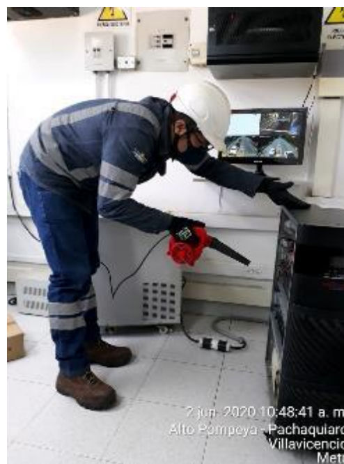
Mantenimiento de equipos
