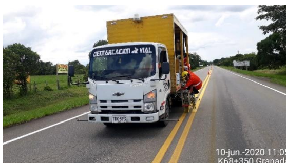
K68+350 Villavicencio - Granada, repintado de la demarcación horizontal por baja reflectividad.
