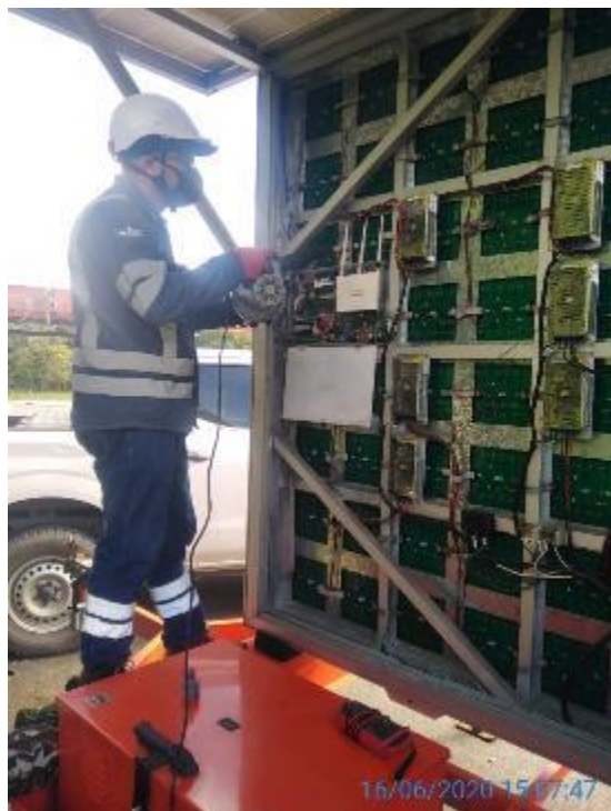
Mantenimiento de equipos Panel de Mensajería Variable
