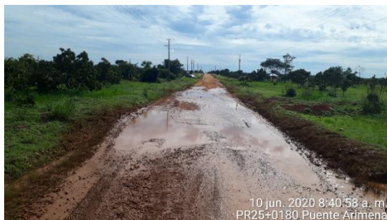
PR25+0180 Puerto Gaitán – Puente Arimena estado del carreteable antes de la intervención.
