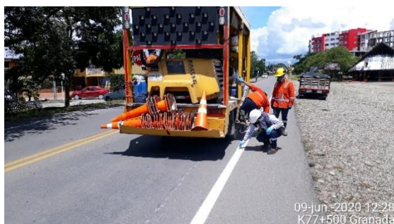
K77+500 Villavicencio - Granada, repintado de la demarcación horizontal por baja reflectividad.
