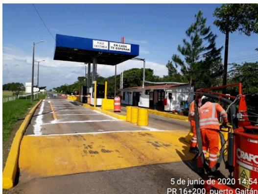
PR16+0200 Puerto López – Puerto Gaitán: sello de juntas y fisuras.
