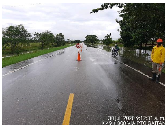
K49+800 Villavicencio – Puerto López, apoyo de las empresas de mantenimiento rutinario en el control del tránsito y señalización de uno de los sitios afectados.
