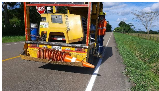
K13 Villavicencio - Puerto López, repintado de la demarcación horizontal por baja reflectividad.
