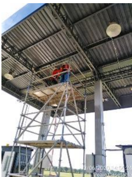
Mantenimiento de luminarias de cubierta Peaje Yucao PR99+0600
