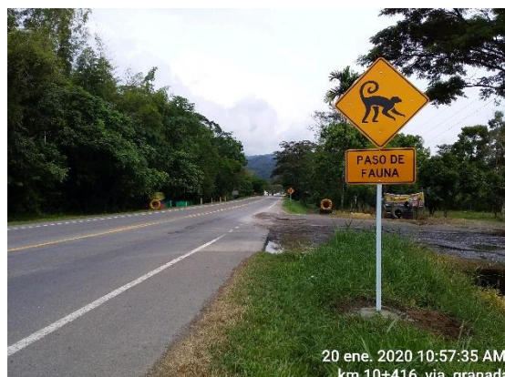
K10+416 Villavicencio – Granada, instalación de señal SP-49, complementada con texto de "paso de fauna".
