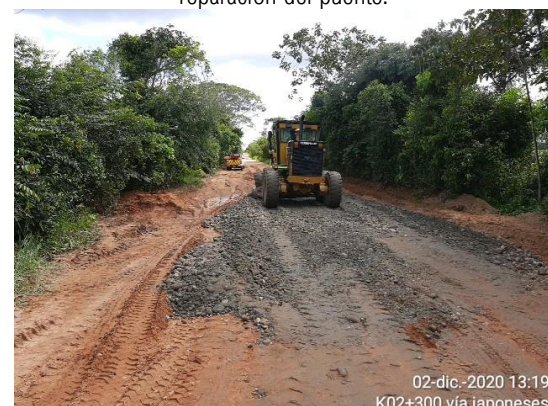
PR24+0850 Puerto López – Puerto Gaitán, habilitación de la vía alterna cruce de Los Japoneses – Puerto Gaitán, en caso de requerir usar como vía alterna.
