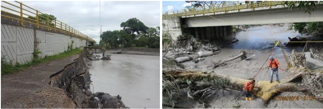
K39+446 Caño Negritos: socavación lateral de la ribera izquierda aguas arriba del puente nuevo y la pérdida de suelos de la franja que conformaba la zona adyacente entre al acceso sur y el cauce del caño; actividades de retiro de material vegetal represado en el cauce bajo el puente.
