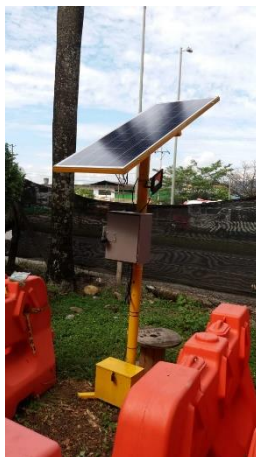
Estación de Energía Solar
